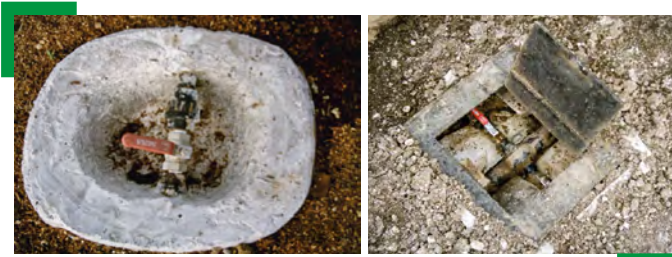
Fig. 50 Registros de válvulas.
