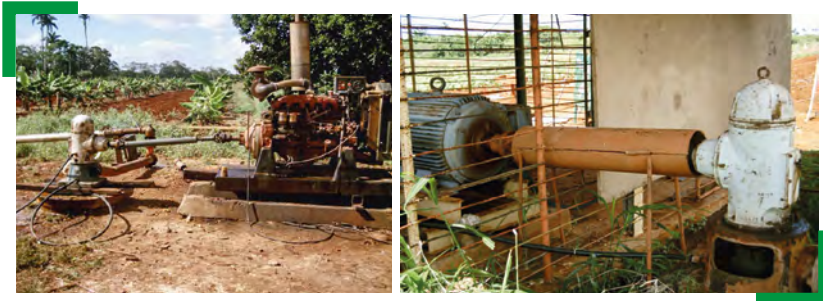
Fig. 56 Izquierda: motobomba diesel sin protección. Derecha: motobomba protegida.
