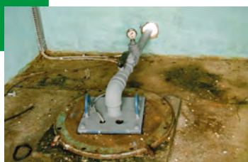
Fig. 54 Motobomba sumergible con caseta, válvula de retención, manómetro, válvula de control y panel de control.
