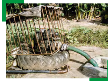
Fig. 55 Motor protegido con caseta.
