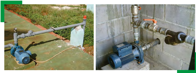
Fig. 53 Izquierda: motobomba eléctrica sin caseta. Derecha: motobomba eléctrica protegida con caseta.
