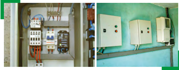
Fig. 52 Cajas con mecanismos eléctricos de protección.
